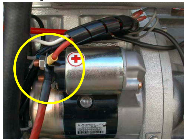
Fig. 6.15.3-4: Pluskabel der Starterbatterie
