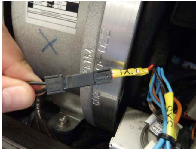
Fig. 14.5-1: Not Stop Brücke im Kabelbaum
