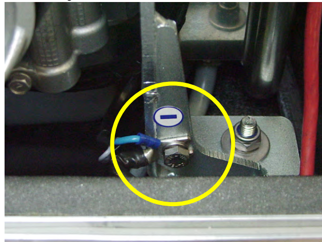
Fig. 8.11.3-5: Minuskabel der Starterbatterie
